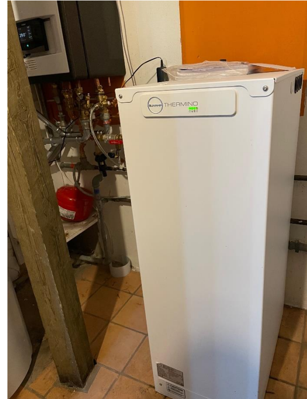
Test af saltlager (varmebatteri)
